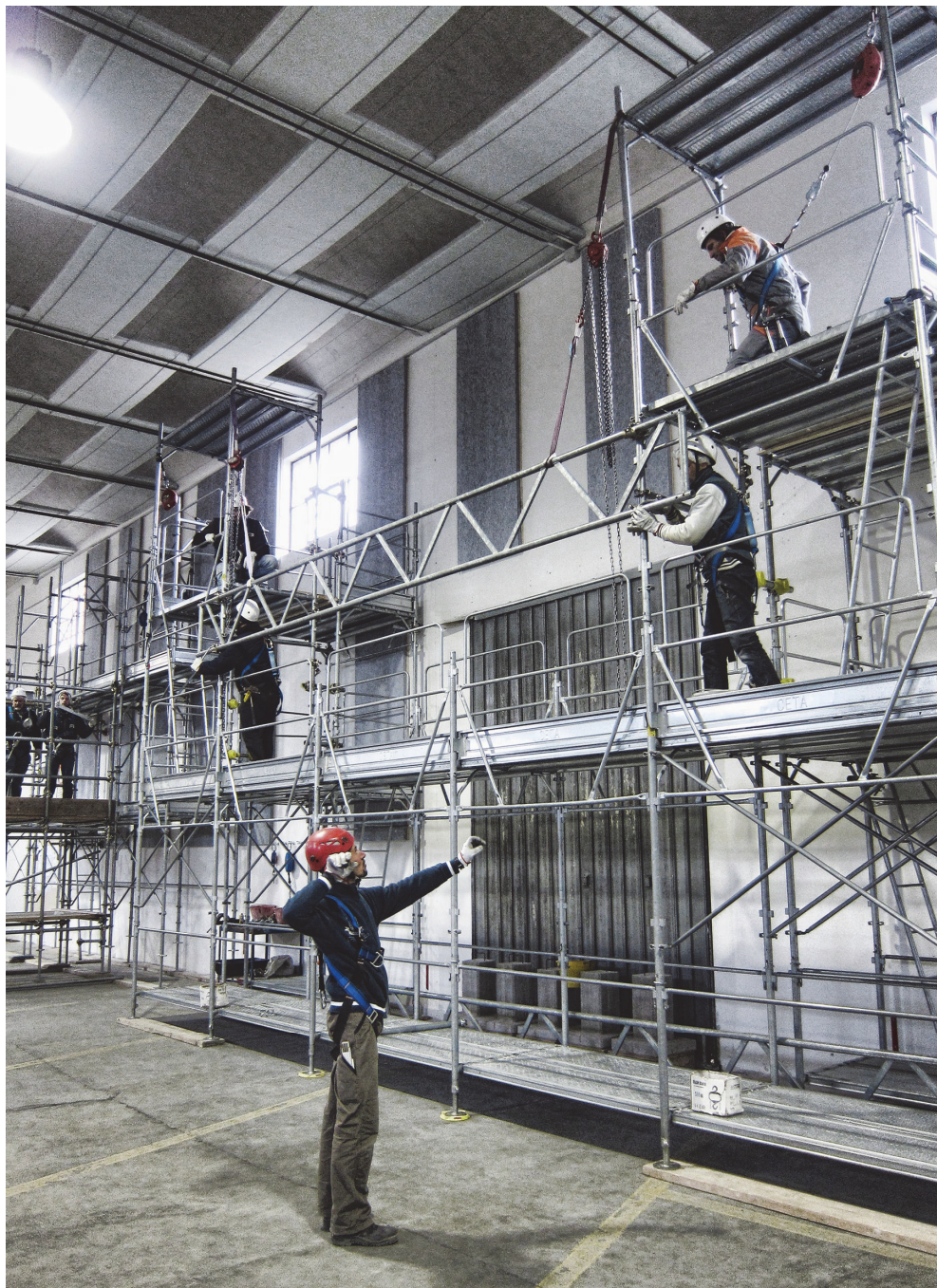
Un corso di formazione al corretto utilizzo dei ponteggi, presso il capannone della Scuola Edile presso via Lotto
